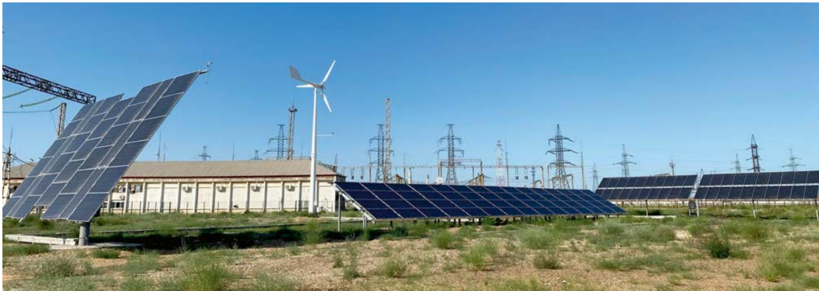
Гибридная электроустановка в Астраханском РМЭС филиала ПАО «Россети» — МЭС Юга
