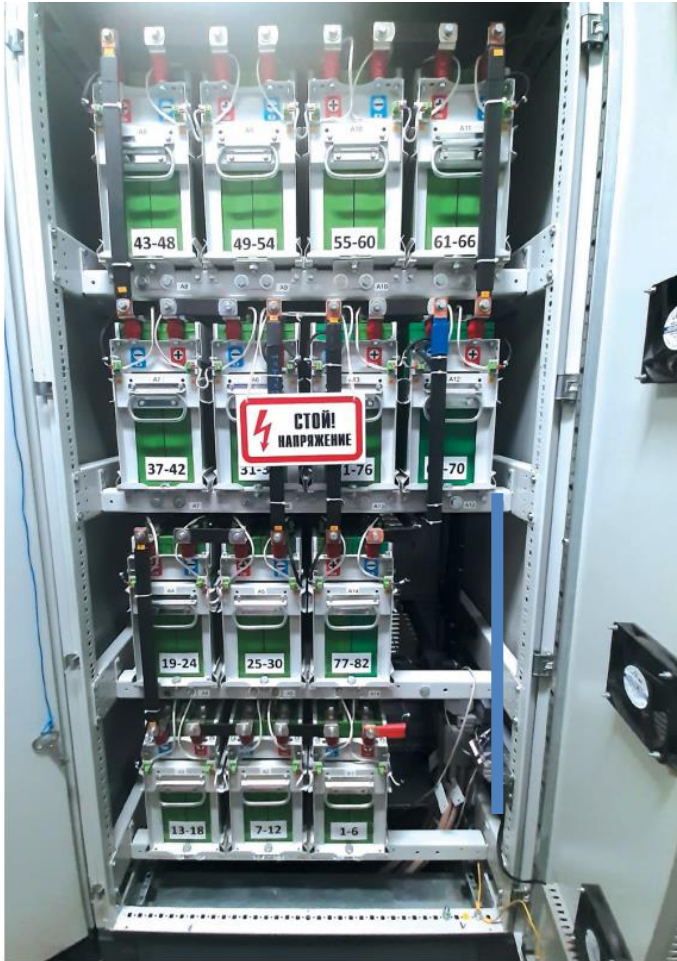
Внешний вид шкафа ЛИАБ
